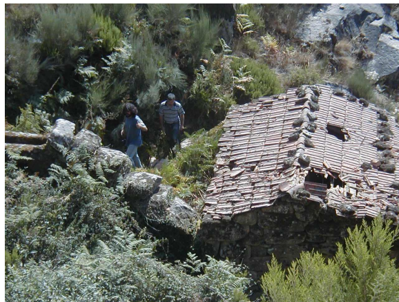
Detalle de tejado roto por efecto de las piedras que han caído sobre el molino n.º 5
