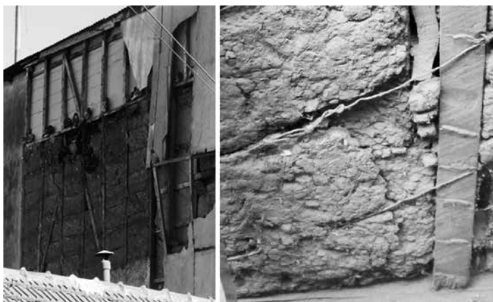
Figura 9: Presencia del tabique de madera relleno con adobe en pandereta en un segundo piso de una vivienda (a la izquierda) y en un muro divisorio interior (a la derecha). Fuente: (Rojas, 2016).
