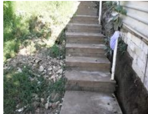
Fotografía 23.-Cárdenas, V. Fracción de escalera de concreto en andador Apalaches. 2008.
