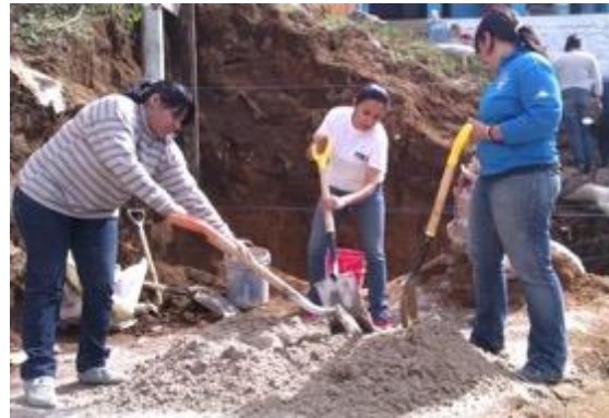
Fotografía 25.- Cerqueda, A. Estudiantes en la realización de mortero para colocar piedra en cimentación. 2012
