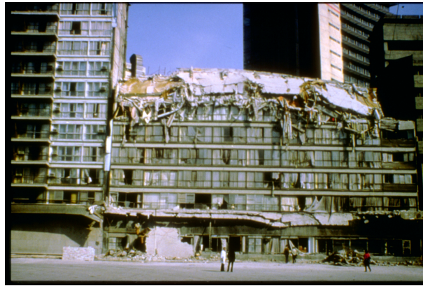
Figura 19: Derrumbe del Hotel Continental ocurrido durante el terremoto de 1985 en ciudad de México. Este edificio entró en resonancia con la frecuencia de forzaje del temblor, y sus pisos superiores colapsaron. Otros edificios contiguos, más altos o más bajos, no sufrieron los mismos daños que este hotel.
