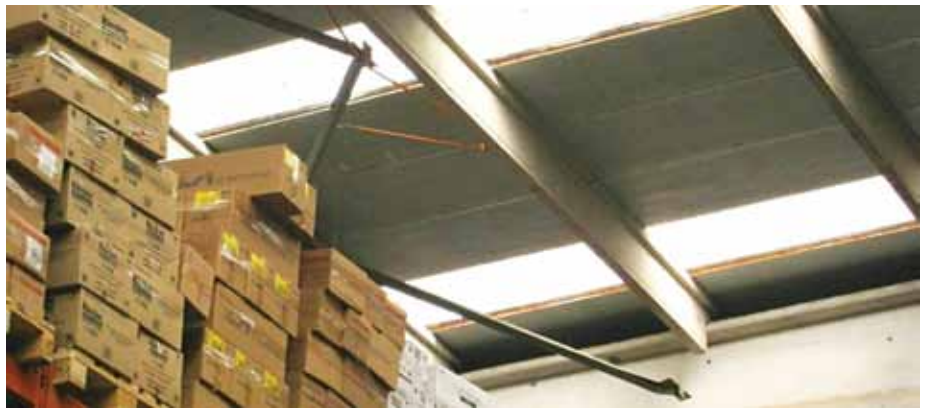
Figura 3.24. Ángulos formando un tubo, falla en la conexión.
