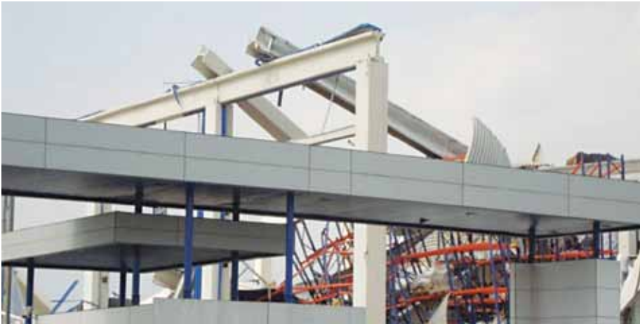
Figura 3.16. Volcamiento y caída de viga secundaria tipo Tau.
