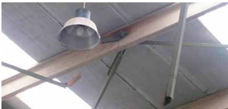
Figura 3.22. Fallas de conexiones por soldaduras defectuosas en sitio, y perfiles sub dimensionados.
