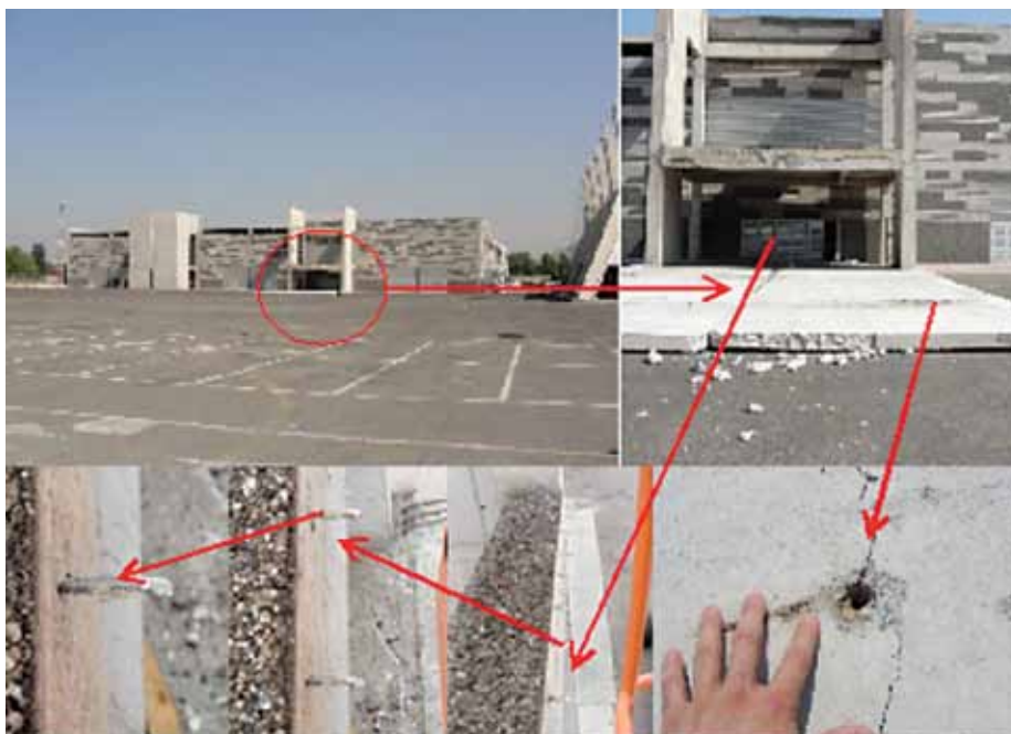
Figura 3.33. Caída de paneles debido a falla de anclajes con adhesivo epóxico en sistema Tilt up.
