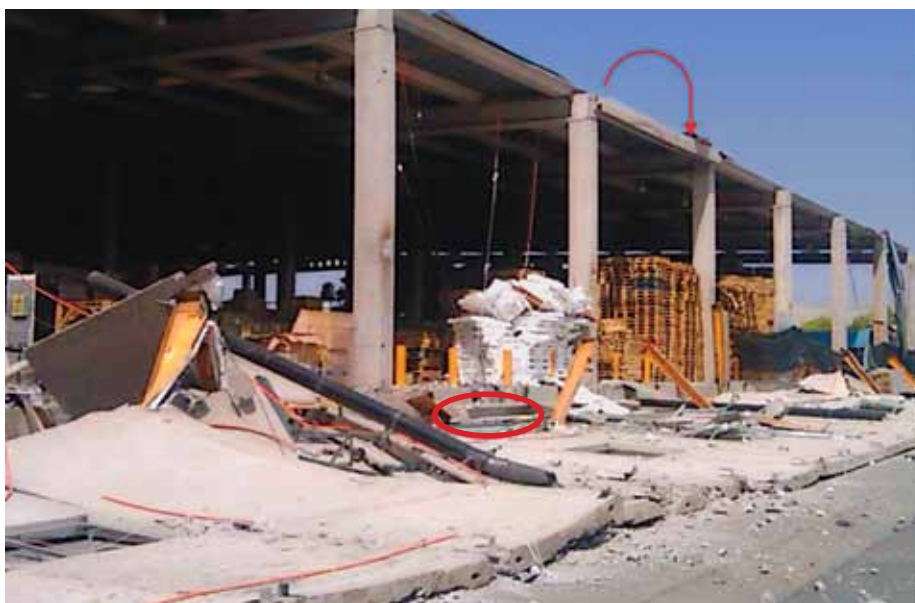
Figura 3.34. Caída de paneles laterales y vigas de borde.
