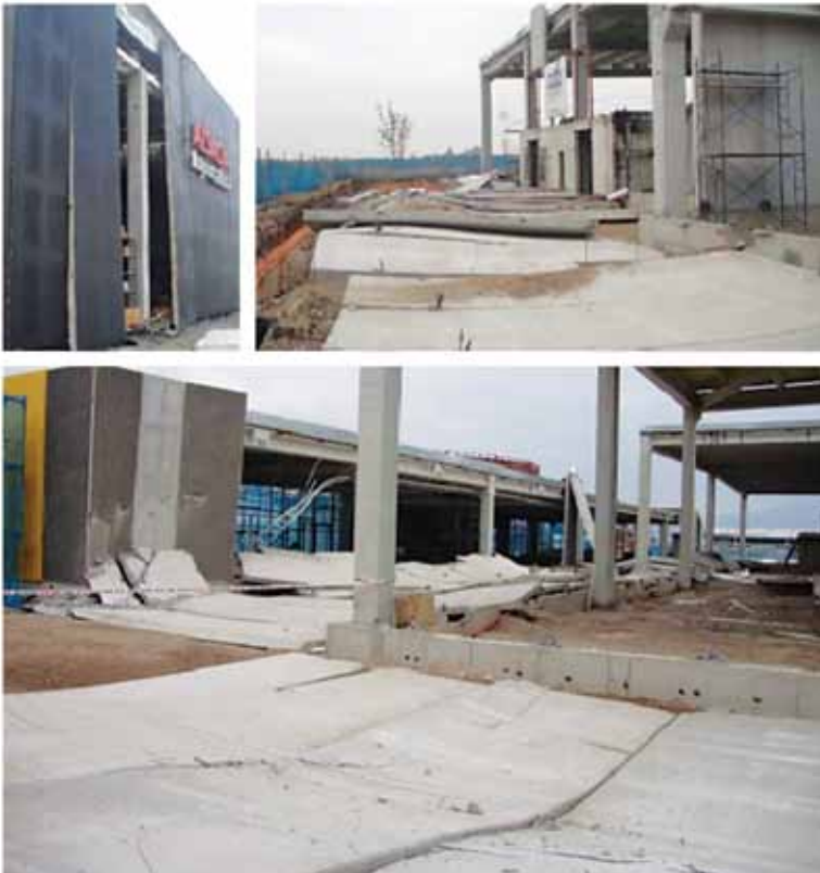
Figura 3.29. Paneles prefabricados de hormigón de gran formato que se desconectaron o cayeron.
