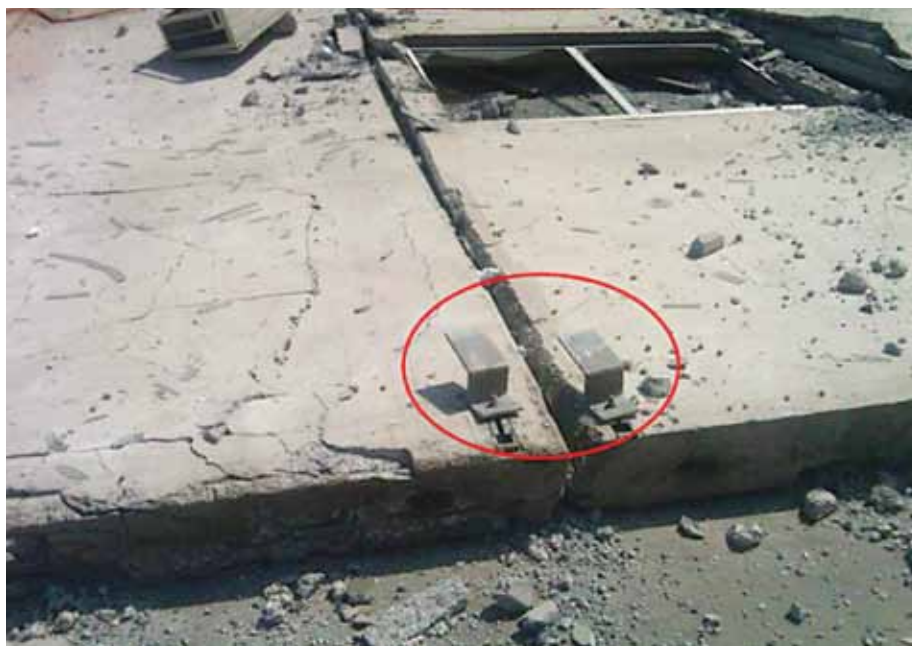
Figura 3.35. Caída de paneles laterales debido a falla de vigas de borde.
