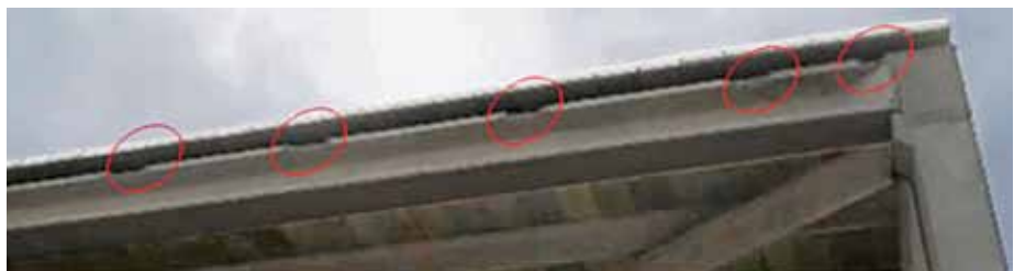
Figura 3.32. Desprendimiento de insertos por anclajes en zonas sin confinamiento.
