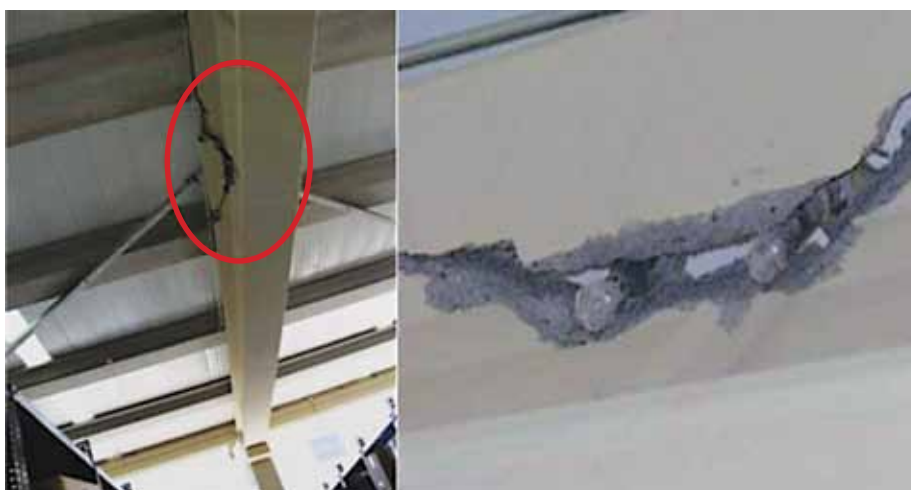
Figura 3.21. Desprendimiento del anclaje, por estar ejecutado en un volumen no confinado de la viga.
