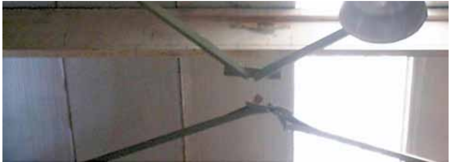
Figura 3.23. Ángulos formando un tubo, evidencia de falla por pandeo.
