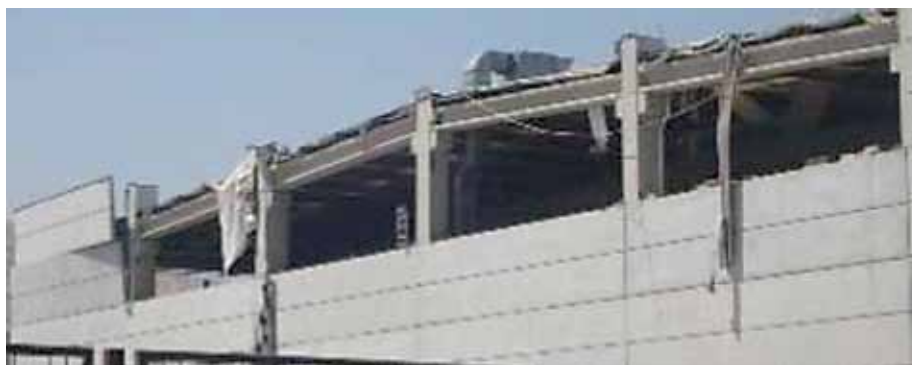
Figura 3.36. Caída de paneles horizontales.
