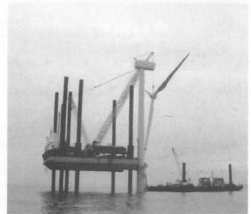
Central de energía eólica irlandesa en construcción. El proyecto Arklow Banks en el Mar de Irlanda tendrá 200 turbinas y producirá 520 MW de potencia eléctrica (tres veces la capacidad de todas las “granjas” eólicas marinas juntas que hasta el momento funcionan en el mundo).
