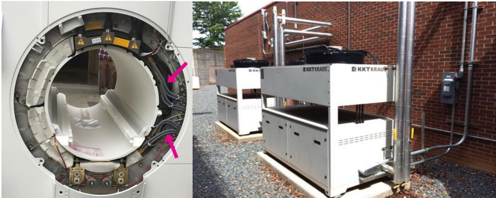
Figura 13: Izquierda, mangueras de enfriamiento de las bobinas de gradientes. Derecha, Chiller externo que envía agua fría al interior de las mangueras.
